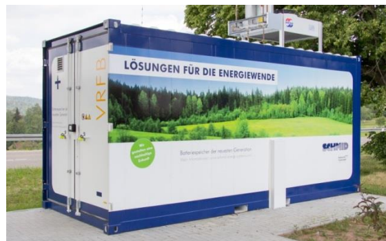
Das Herzstück der autarken E-Tankstelle: Ein stationärer Energiespeicher der SCHMID Energy Systems GmbH
